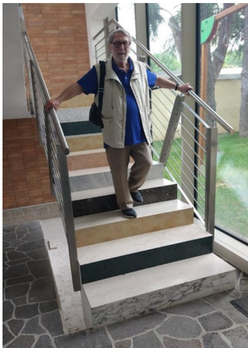
Camillo Bianchi al Gregorianum per visionare le nuove scale e i parapetti (2022)
